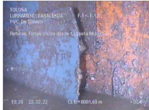
Fotografía: 12_2b 1,6m, Roturas. Faltan trozos desde 12 hasta 06 horas
